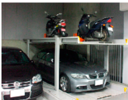
多段地下ピット式：東京都新宿区
