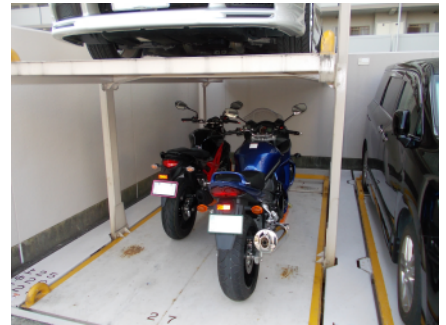
大阪市旭区 地下ピット単純昇降式
