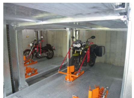
東京都八王子市 地下ピット単純昇降式
